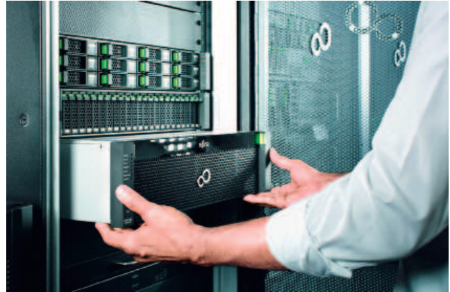
ThingWorx meldet Störungen automatisch. Wird der Austausch von Komponenten notwendig, kann dieser dann auch im laufenden Betrieb erfolgen.
